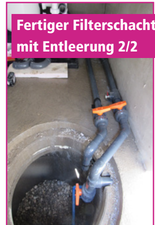
Fertiger Filterschacht mit Entleerung 1/2
